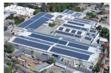
Hilcasa様の工場に設置した太陽光発電システム
